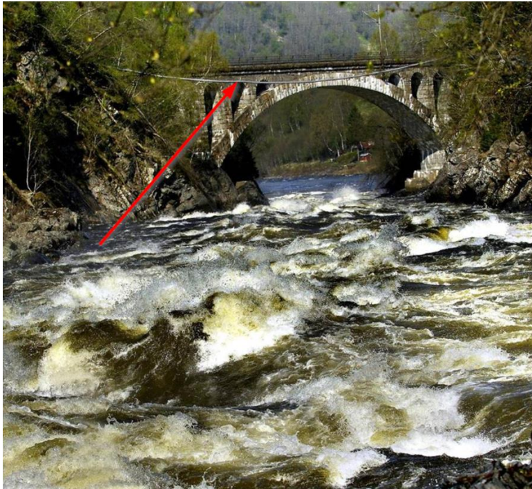
Figur 3-2: Ledning over Gaulfossen som tilsynelatende tilhører Hovinåsen vannverk.
